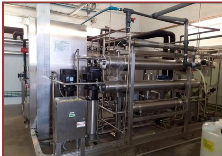
Figure 8 Station de traitement d'eau industrielle par osmose inverse au sein de l'établissement SAIDAL - Constantine 2- (photo personnelle).
