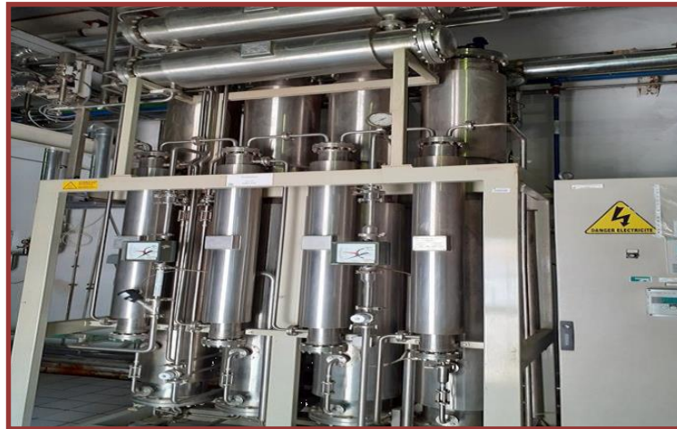
Figure 11 Station de traitement d'eau brute par distillation au sein de l'établissement SAIDAL (photo personnelle).
