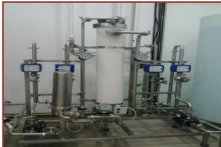
Figure 13 Appareil d'ultrafiltration au sein d'une station d'eau purifiée de SAIDAL (photo personnelle).
